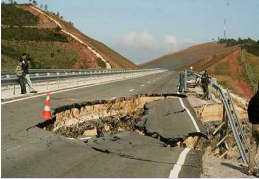
Landslide on the Tétouan-Fnideq highway in January 2008 2008年1月のTétouan-Fnideq高速道路上の地すべり
