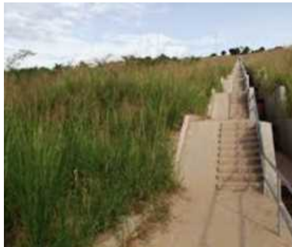
水を集めて下流の川に避難し、ベチバーを植えるための階段状の水路の建設
