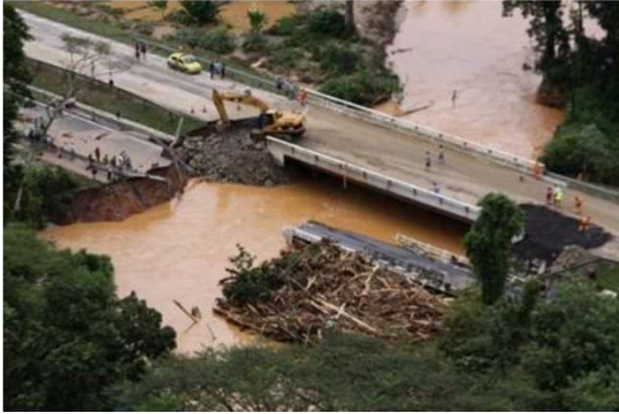
Bridge damaged - Highway BR-277/PR (2011) 橋梁損傷 - ハイウェイ
